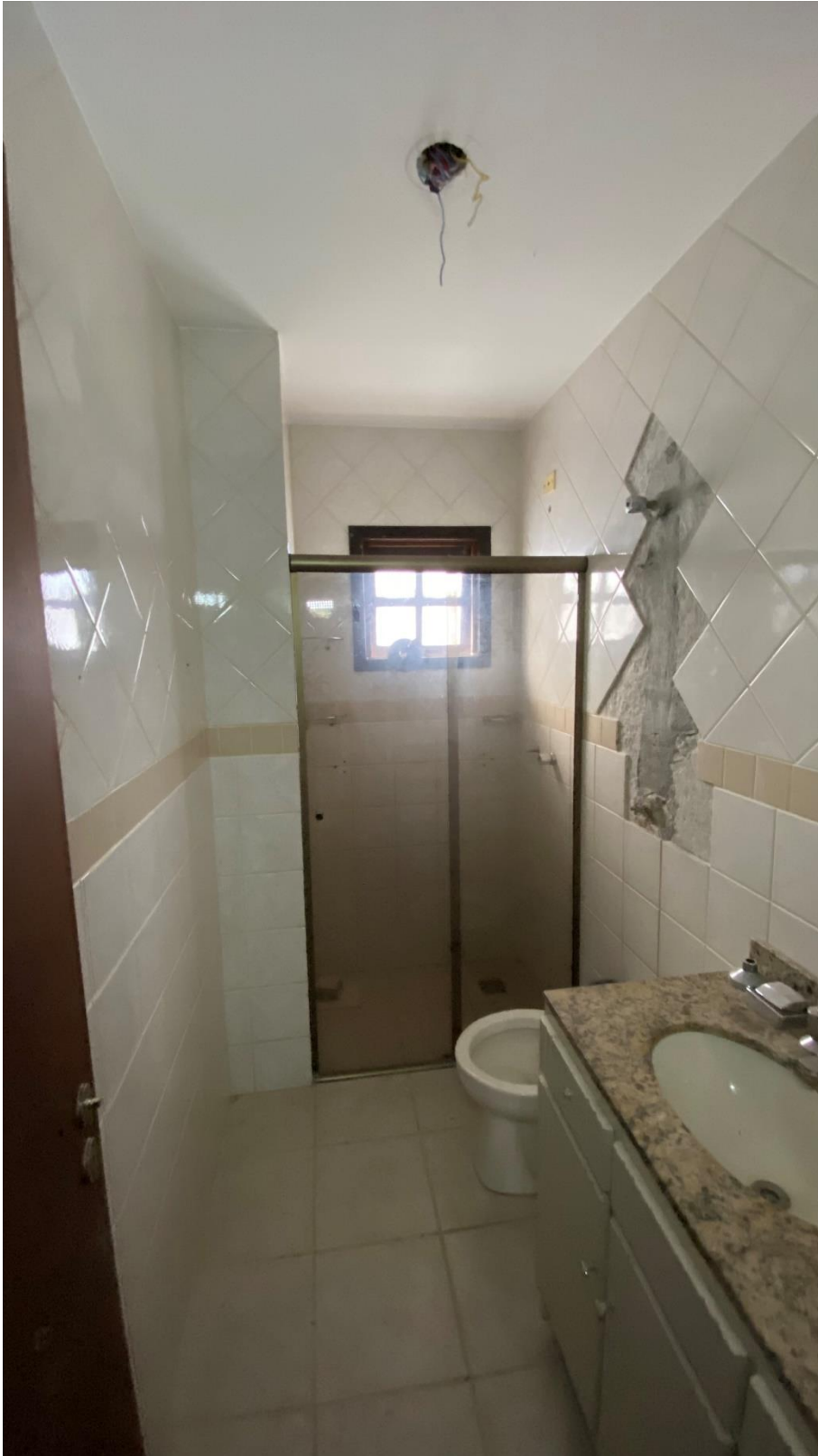
BANHEIRO SOCIAL – SEM LUMINÁRIAS
