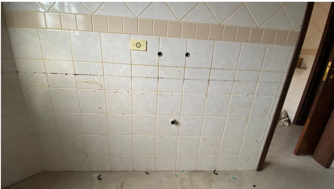
PAREDE COZINHA – TUBULAÇÃO ÁGUA QUENTE E FRIA
