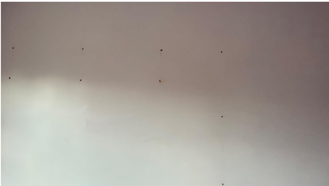
QUARTO FUNDOS – PAREDE COM DIVERSOS FUROS
