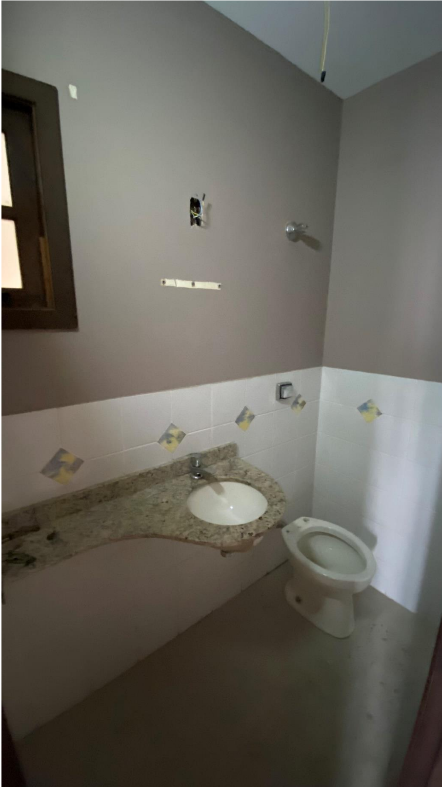
LAVABO – LUMINÁRIAS FORAM RETIRADAS
