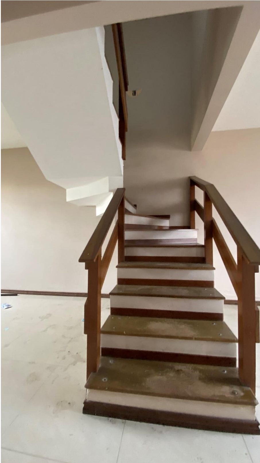
ESCADA DE ACESSO AO PAV.SUPERIOR – PISO EM MADEIRA COM RISCOS E VERNIS DESGASTADO
