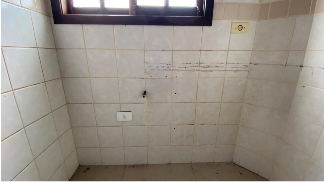
PAREDE FUNDOS COZINHA – TUBULAÇÃO DE GÁS EMBUTIDA NA PAREDE
