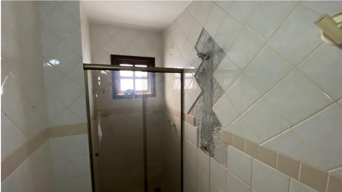
BANHEIRO SOCIAL – APARENTEMENTE FOI FEITO UM REPARO NA DESCARGA
