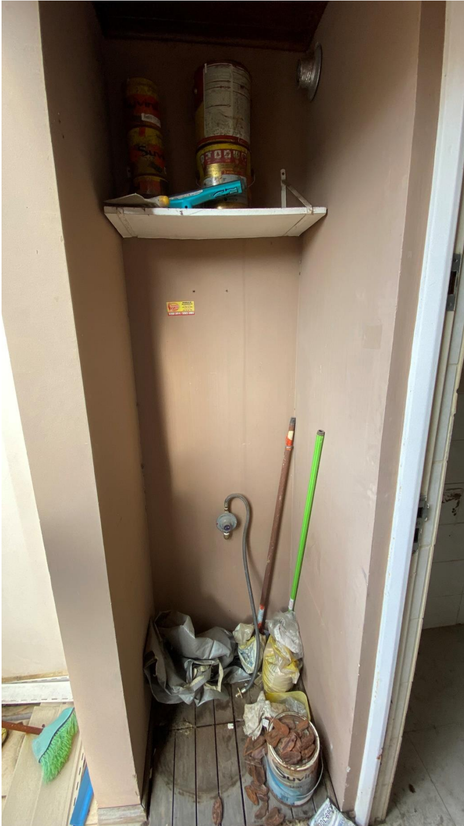
CENTRAL DE GÁS – ENTRE LAVANDERIA E QUINTAL DOS FUNDOS
