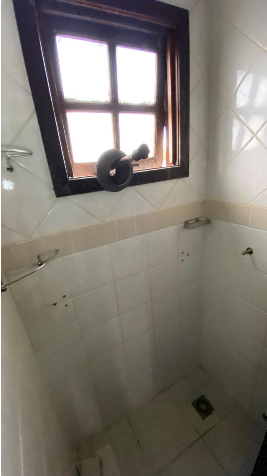
BOX BANHEIRO SOCIAL – COM FUROS NO AZULEIJO E SEM ACABAMENTO DO REGISTRO DO CHUVEIRO
